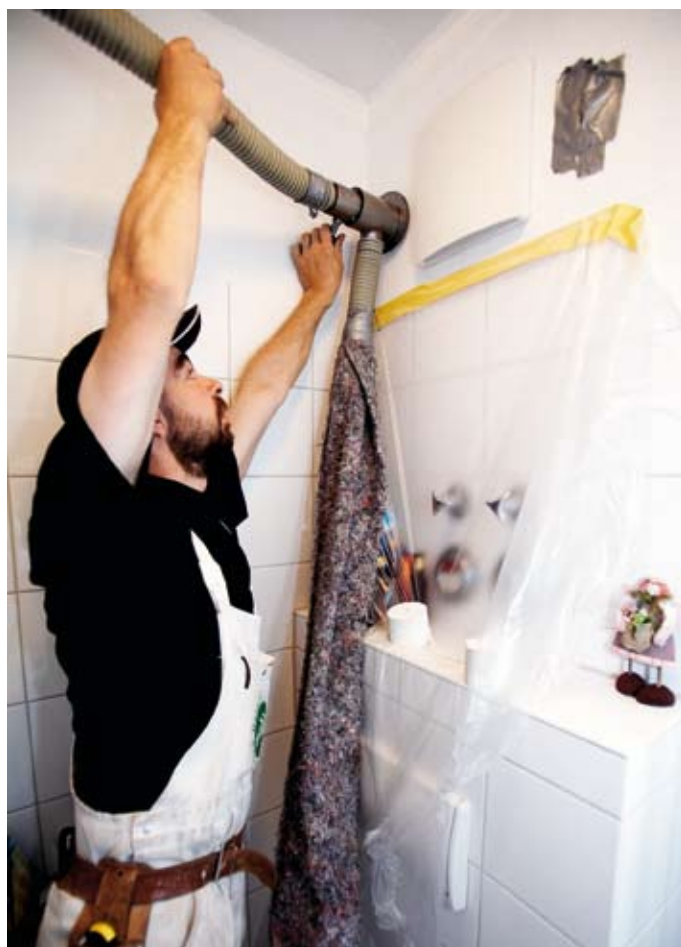
■ Die lückenlose Schachtverfüllung mit dem Mineralfaser-Dämmstoff verbessert - neben der Umrüstung in einen 190 zugelassenen Schacht - auch den Schallschutzkomfort.
