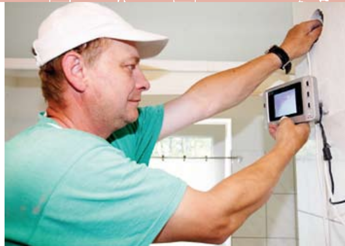
■ ...und prüft mithilfe einer Videokamera zunächst die Belegung des Installationsschachtes sowie den Gesamtzustand.
